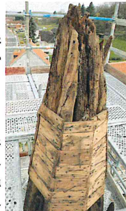
Ancien clocher irrécupérable
